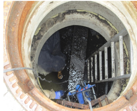
Figuur 6 Bovenkant mangat inclusief ladder, verticaal is een van de betonnen balken op de bodem van het systeem te zien
