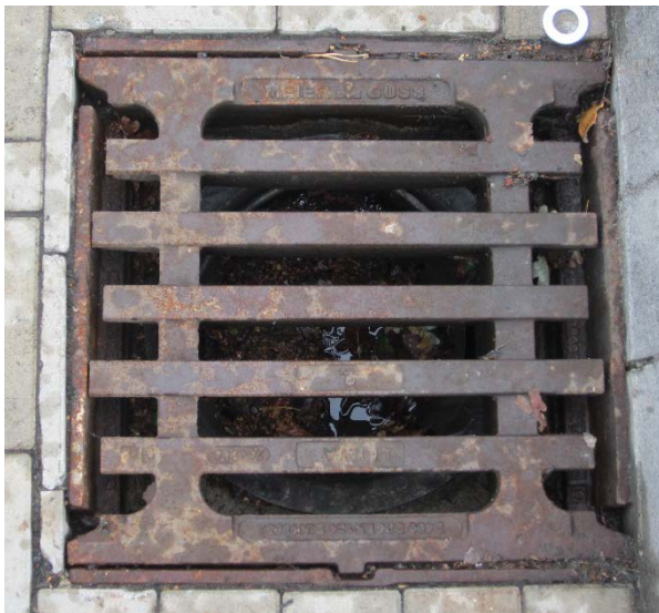
Figuur 4 Straatkolk op het terrein van Paus wat afwatert op het infiltratiesysteem.
