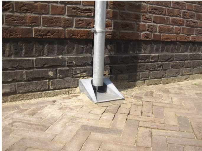
Figuur 16: HWA voorzien van een afkoppelsteen Bron: (Waterwindow, 2018)
